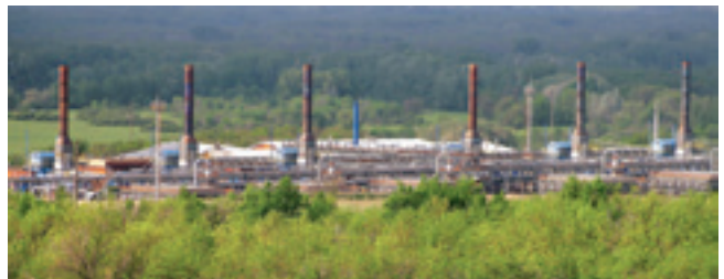
ГТУ-10П в составе газоперекачивающих агрегатов нового поколения. ООО «Газпром добыча Оренбург»
