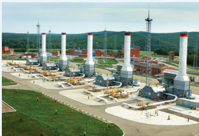
Газотурбинные установки ГТУ-12ПВ разработки «ОДК-Авиадвигатель» на КС «Краснодарская»
